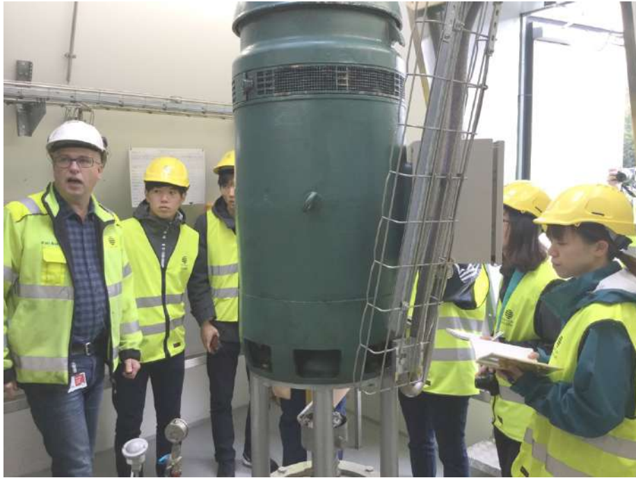
(アイスランドで熱い地下水を持ち上げるポンプステーションを見学する学生)
