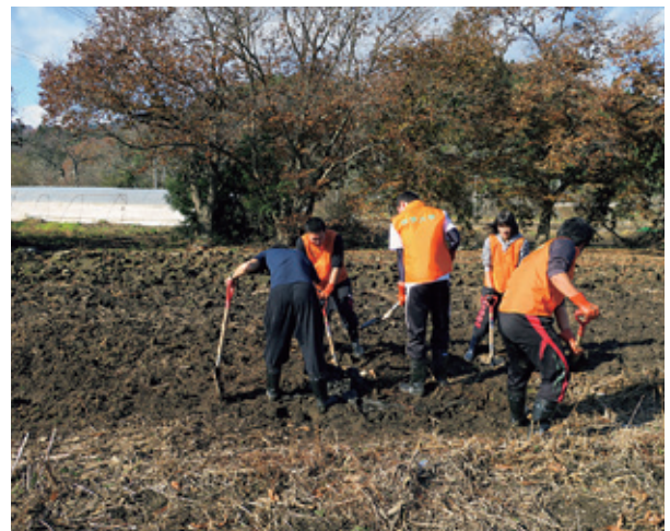
農地の泥出し作業(宮古市)
